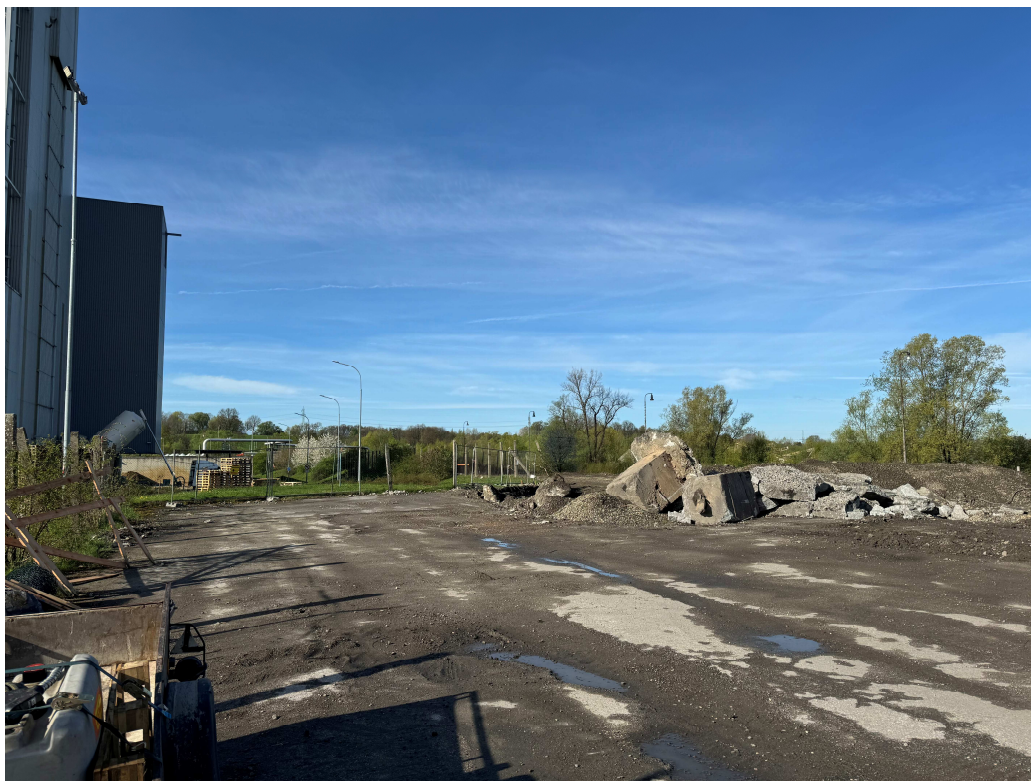
Pohled jižním směrem. Na snímku jsou patrné zbytky původního popílkového sila, které bylo zdemolováno.
