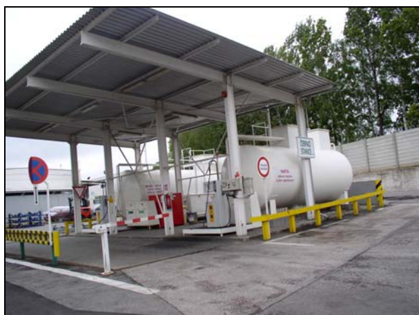
Obrázek 7: Současná ČS s nadzemními zásobníky
