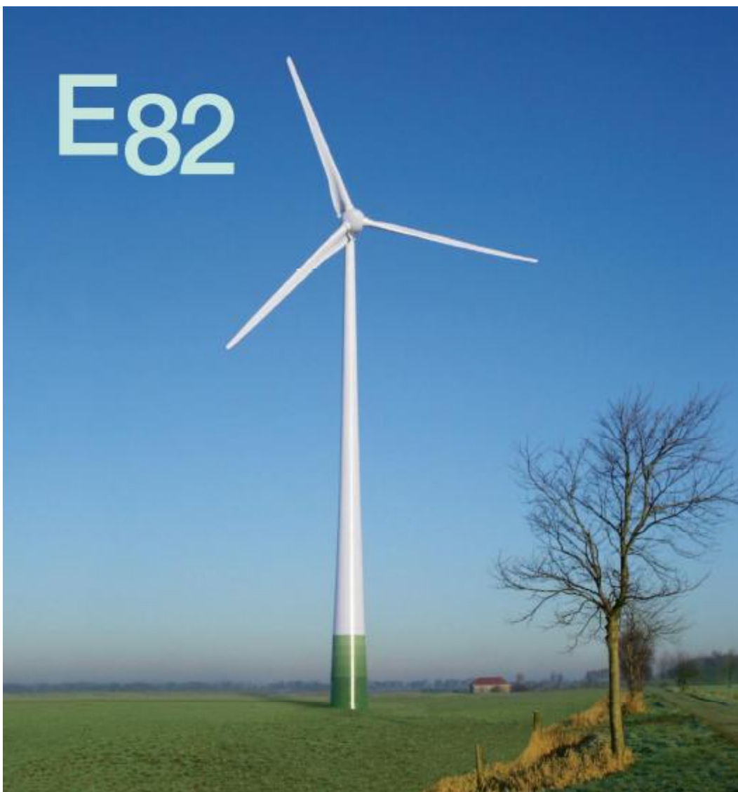
Obr.: Fotografie elektrárny ENERCON E-82
