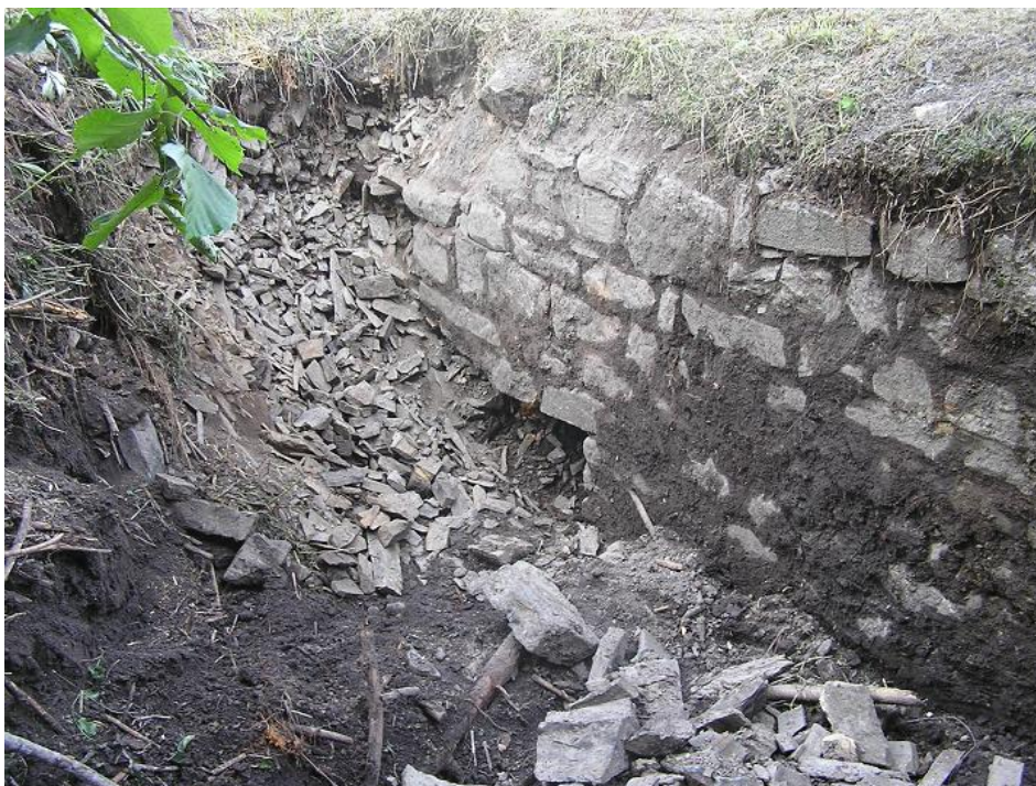
Obr. 4.: Stávající kamenná zeď v místě vtoku propustku. Konstrukce je v nevyhovujícím technickém stavu, částečně je sesunutá a samotný vtok je zanesen bahnem a zeminou.
