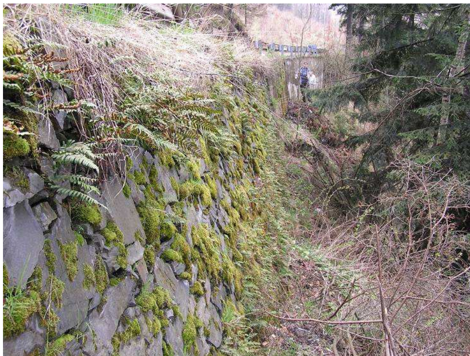
Obr. 8.: Část stávající opěrné zdi z kamenné rovnaniny. Z obrázku je zřetelný nevyhovující technický stav objektu.
