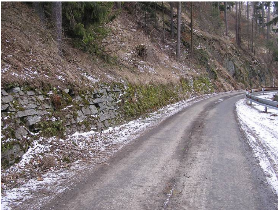
Obr. 7.: Stávající zárubní stěna z kamenné rovnaniny na levé straně svahu. Spáry jsou vydrolené a obrostlé mechem, dále hrozí nebezpečí pádu kamenů do vozovky. Kamenná zídka bude nahrazena zárubní stěnou sestavenou z gabionů.
