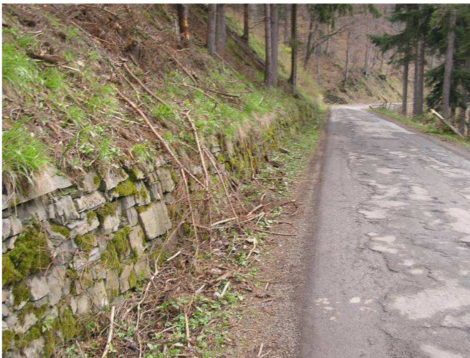
Obr. 5.: Stávající zárubní stěna z kamenné rovnániny na levé straně strmého svahu. Spáry jsou vydrolené a zarostlé mechem. Zřetelné je přesypávání zeminy ze svahu na vozovku. Konstrukce stávající stěny je v nevyhovujícím technickém stavu a bude nahrazena zárubní stěnou zhotovenou z gabionů.
