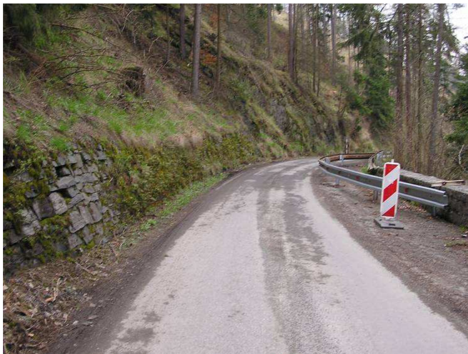
Obr. 3.: Silnice v km cca 1,015 až 1,040. Původní šířka vozovky je v důsledku stržení krajnice na pravé straně zúžena jen na cca 3,0 m. Stávající porušená kamenná zárubní zeď vlevo bude nahrazena gabionovou konstrukcí, opěrná zeď vpravo bude rekonstruována.
