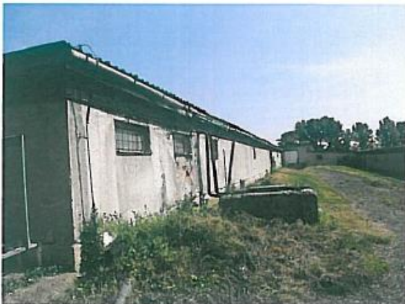
Obr. č. 1a,b,c,d Stav nevyhovujících objektů pro chov prasat
