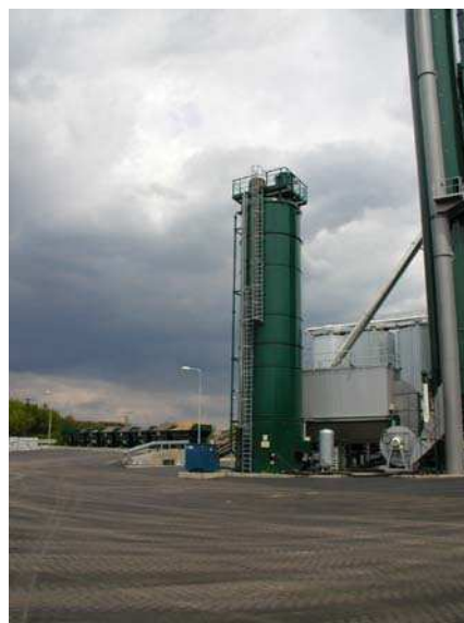
silu hnědouhelného prachu a odprašovací zařízení
