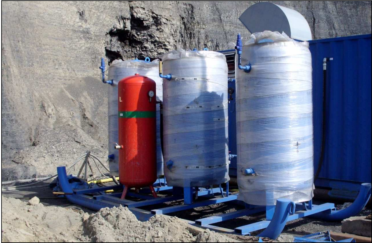
Obr. 2 Tlakové nádoby před kontejnerem – červená (vlevo) – vyrobený dusík, modré (vpravo) – nádoby na odstraňování nečistot a vlhkosti ve vzduchu (kondenzační sušička).
