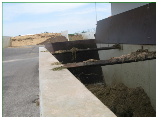
Silážní jámy – přívod pevné hmoty hlavního fermentoru (předzásobník)
