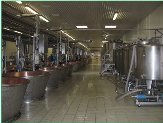
Místnost sýření – sýrařské kotle
