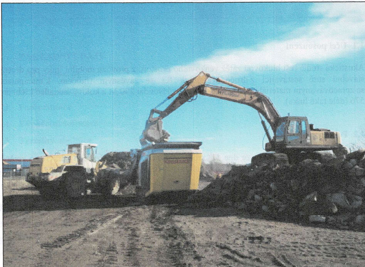
Obrázek č. 1 – Linka na drcení stavební sutě
