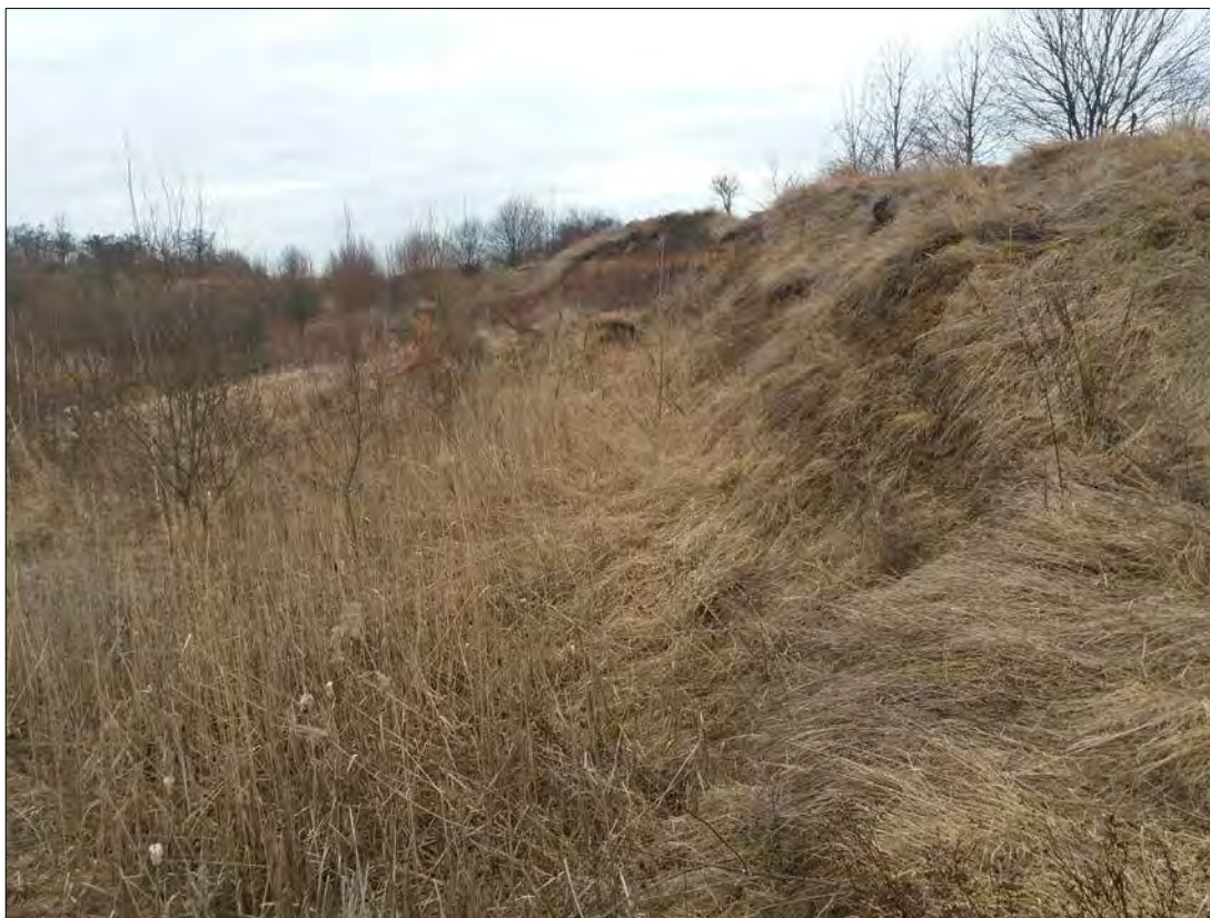
Obrázek 4: Četné svahové deformace na západních svazích bývalé těžebny; foto: Kovář, 2/2022.
