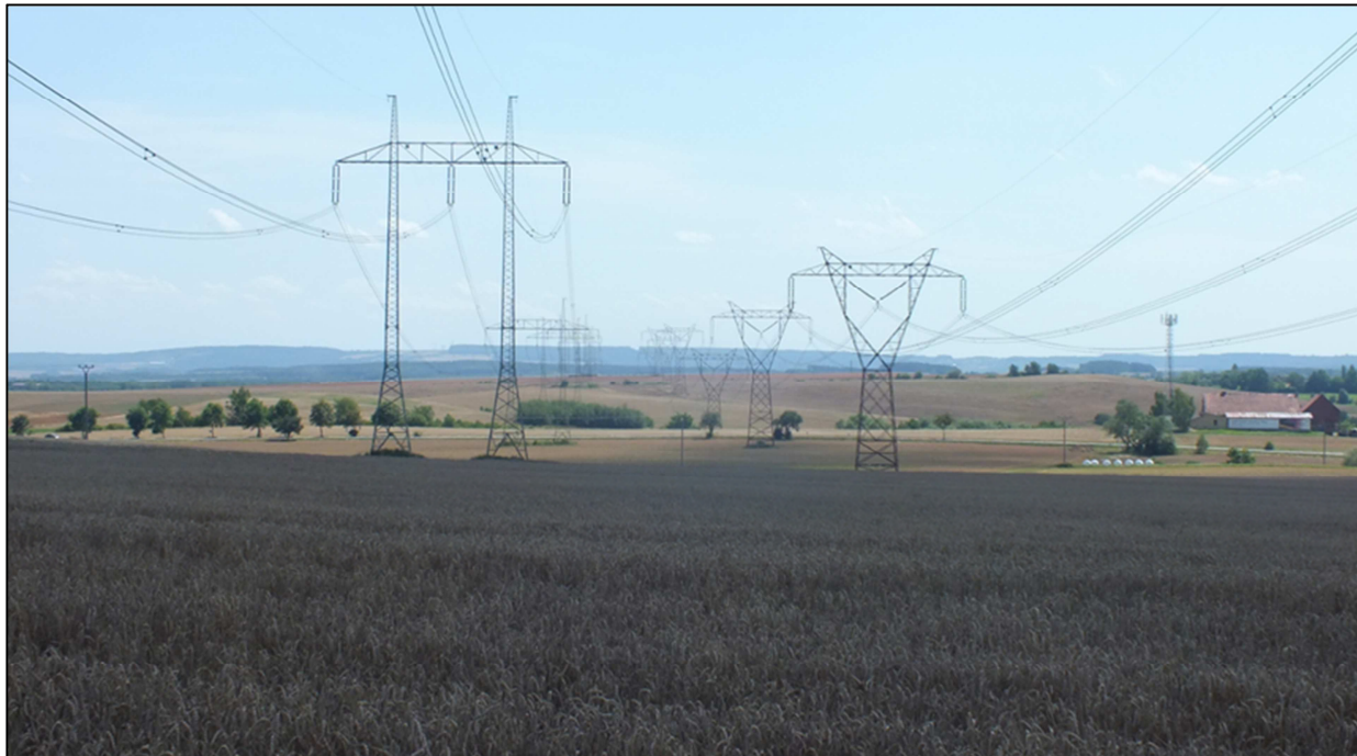
Fotografie 10 Vedení vysokého napětí v místě křížení s D6 – pohled od Nové Vsi směrem ke komunikaci I/6
