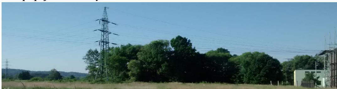
Obrázek č. 33: Část trafostanice TR110/22 kV Č. Budějovice Mladé stanice v návaznosti na další přípojovací stožáry
