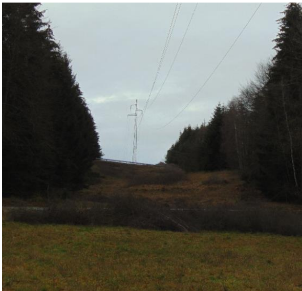
Obr. č. 15: Vedení VVN směrem od obce Chobot, které vede lesním průsekem
