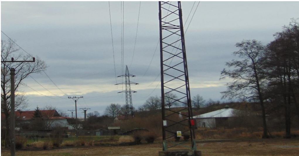
Obr. č. 17: Vedení VVN vedoucí směrem k Bezdědovicům
