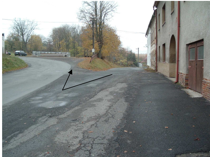
Obr. č.8. Křižovatka silnice č.II/201 (vlevo) se silnicí č.III/20165 Lestkov - Hanov (vpravo) s problémovým odbočením vpravo
