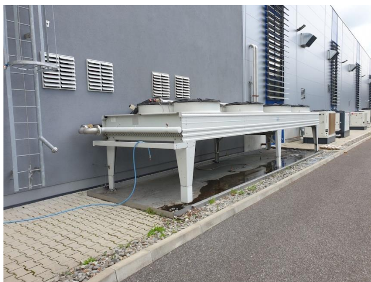
Obr. č. 4 Chladič kompresorů
