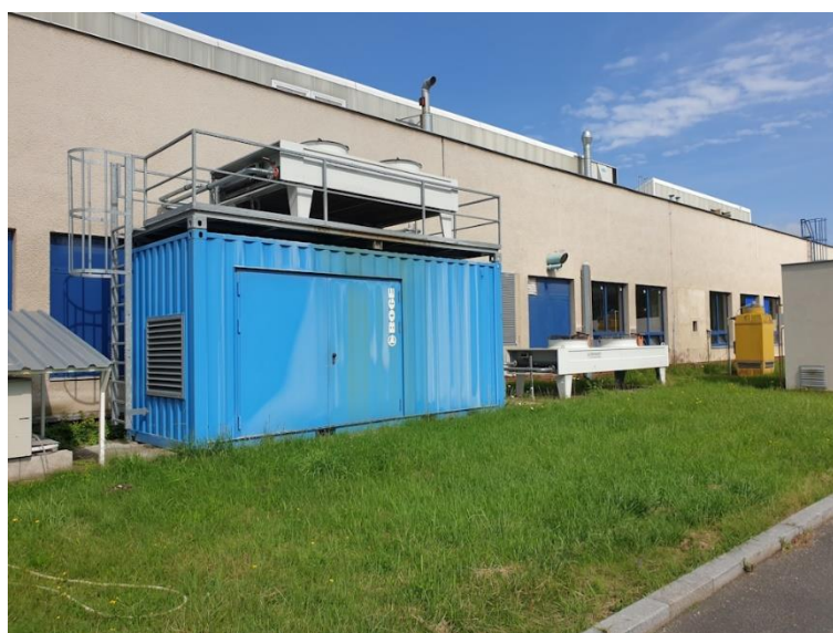
Obr. č. 5 Venkovní kompresor v kontejneru u haly č. 5
