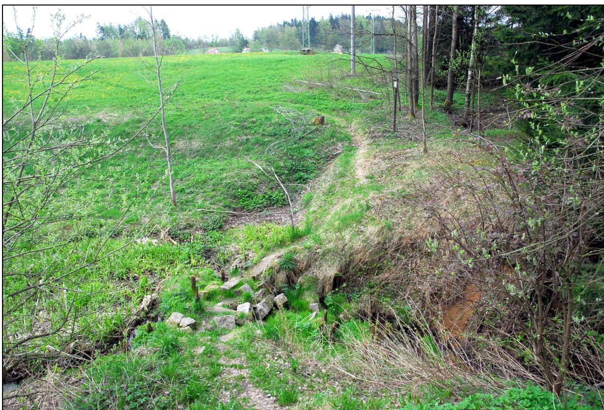
Porušená hráz rybníčka Horní Proseč
