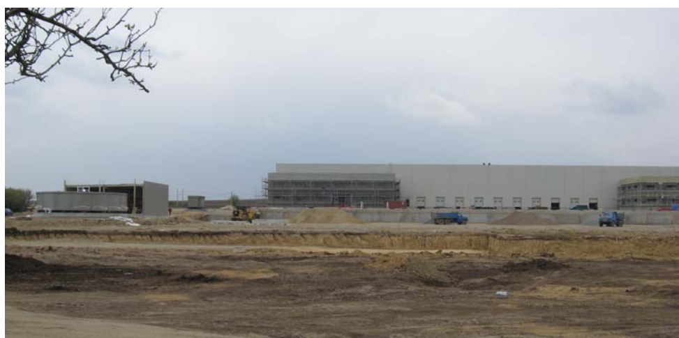
Areál CTParku Šlapanice, dokončovaná hala SA4 v pozadí, v popředí bude realizována hala SA1
