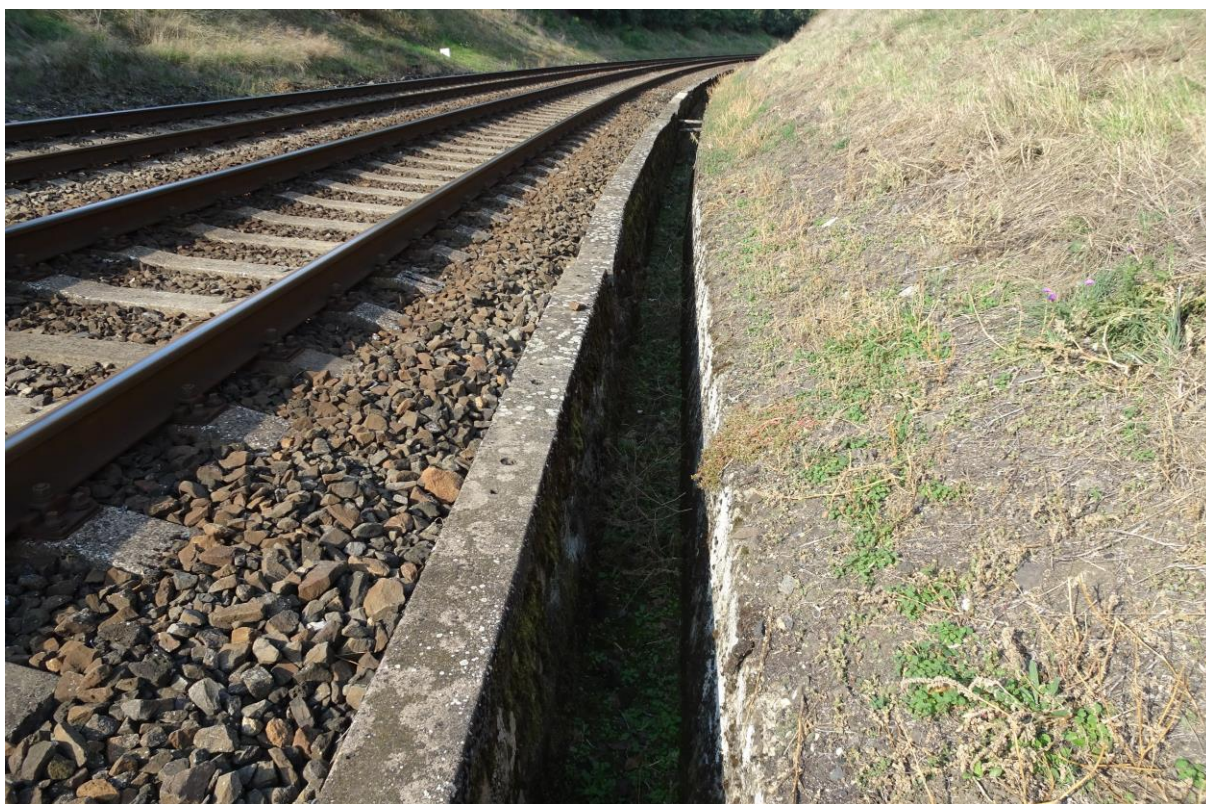
Obr. 10: Pro živočichy nebezpečný odvodňovací žlab v úseku km 65,64–66,55 (5. 10. 2018)
