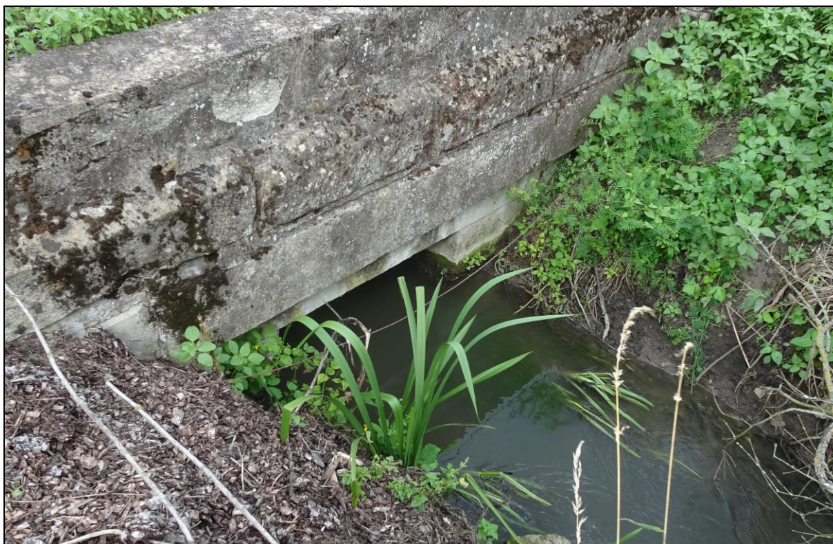
Obr. 14: Pro migrace menších obratlovců nevhodný propustek v ev. km 82,074 (14. 6. 2018)
