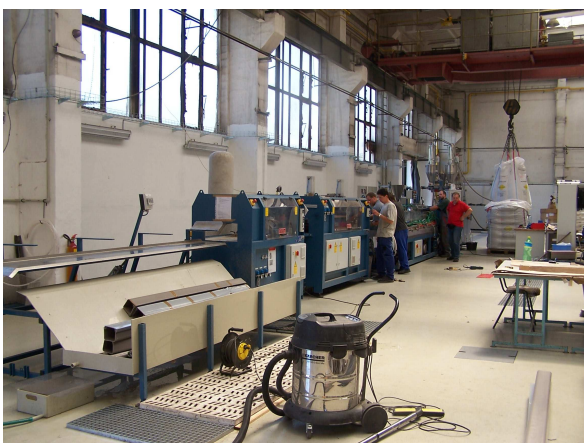
Obr. 5 Pohled na instalovanou extruzní vytlačovací linku
