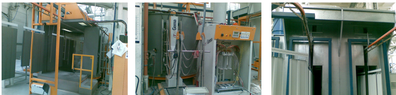
Obr. 6 – 8 – vypalovací pec PP
