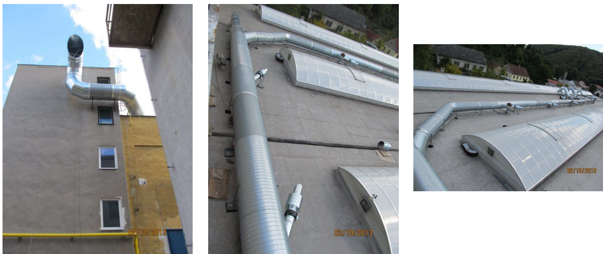
Obr. 12– Odsávací potrubí od vypalování PP s přísáváním vzduchu pro eliminaci pachových látek – stávající stav po úpravách v r. 2013
