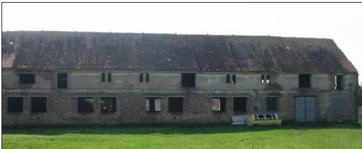
Obr. 46: Zámek v Pouzdřanech v dezolátním stavu
