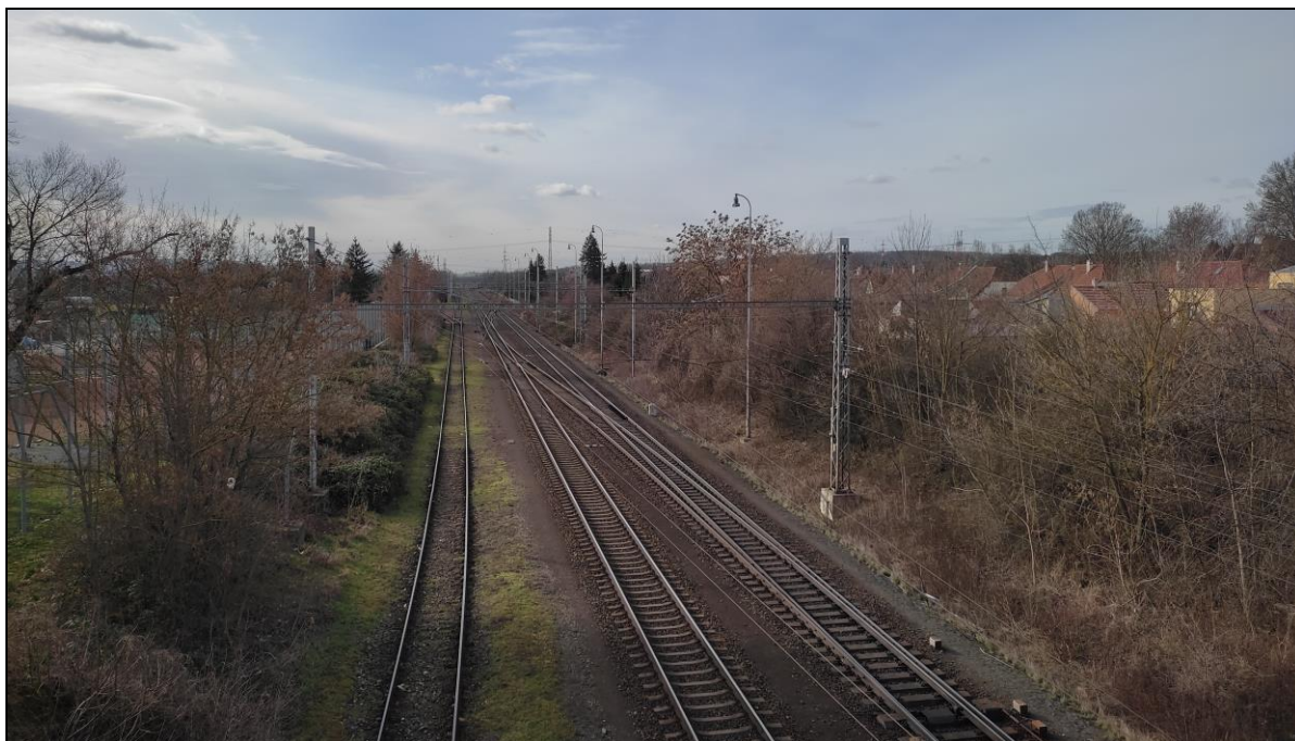
Obr. 51: Pohled z mostu propojující ulici Nádražní a Brněnskou v Modřicích (směrem na jih) na stávající železniční trať, resp. směrem na žst. Modřice; po pravé straně budoucí uvažovaná trať VRT, po levé straně konvenční trať; úsek uvažované oboustranné PHS, zřejmě převládající antropogenní prvky (železniční koridor, trakční vedení stávající železniční trati)
