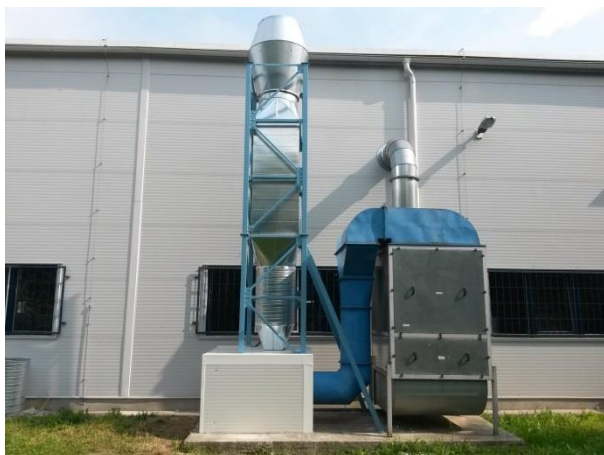
VZT vytlačovacích linek s filtrem, tlumičem a krytem
