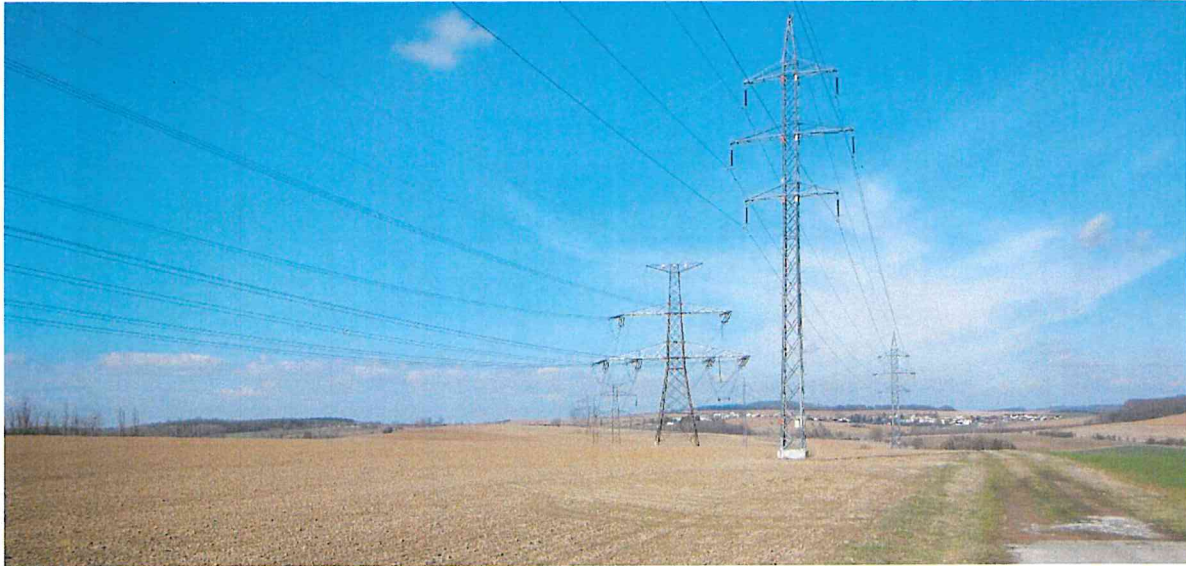
Průchod elektrovedu poli nad Tlumačovem
