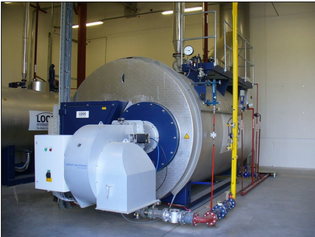
Stávající plynová kotelna pro výrobu technologické páry
