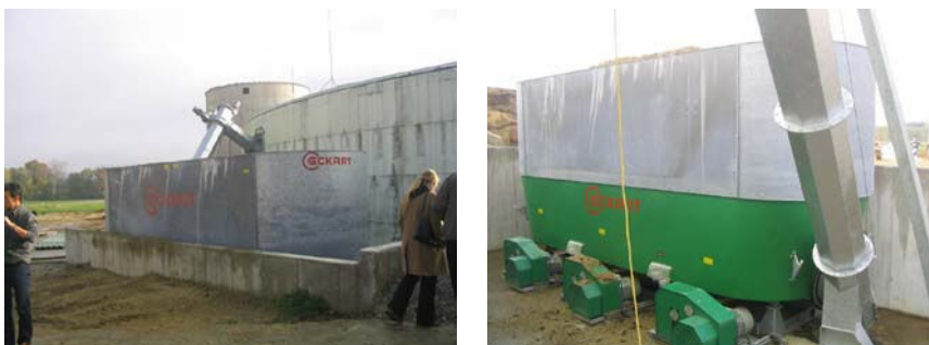
Celkový pohled na příjmové zařízení (BPS Utzenaich, Rakousko)
