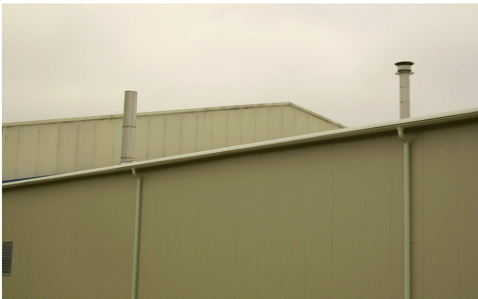
Obr. č.3: Současné výduchy ze zařízení
