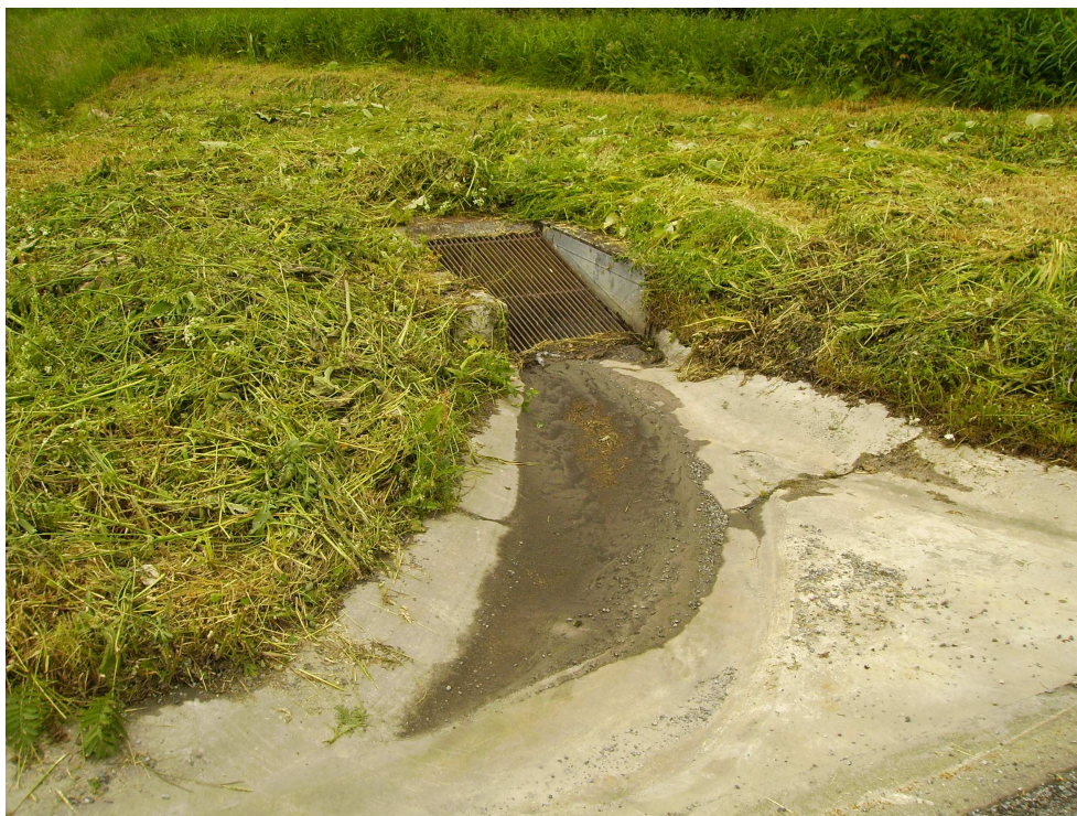
Obr. č.2: Stávající vpust' do odlučovače ropných látek
