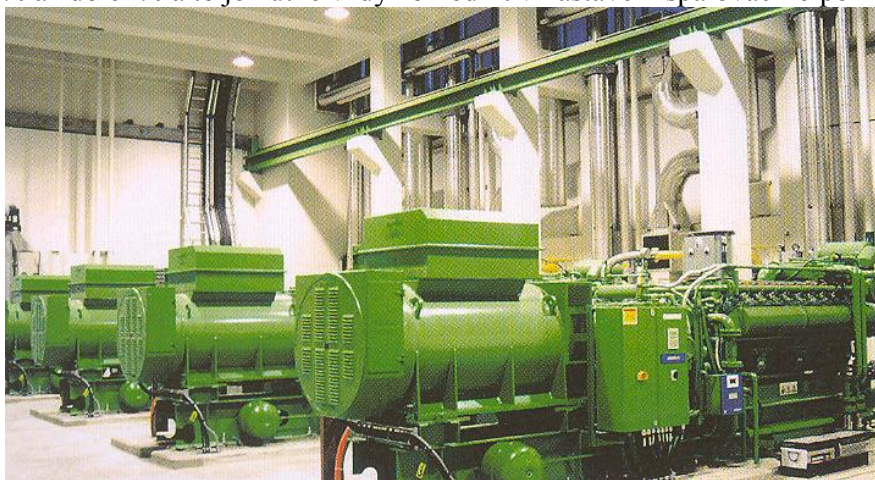
(Pohled na místnost kogenerace)
