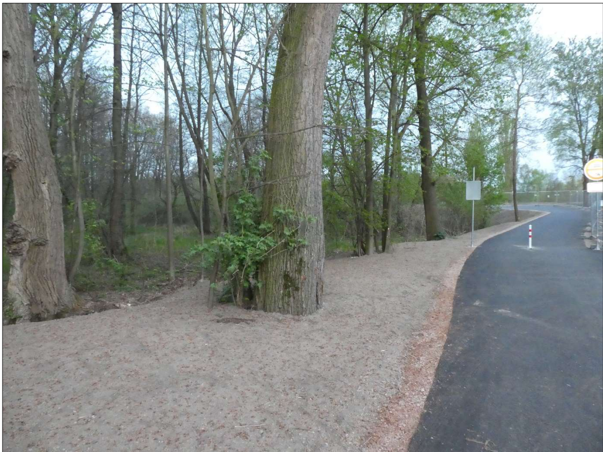
Obr. 12: Nepříliš vhodná úprava okolí kořenových náběhů v souvislosti s realizací asfaltové cesty
