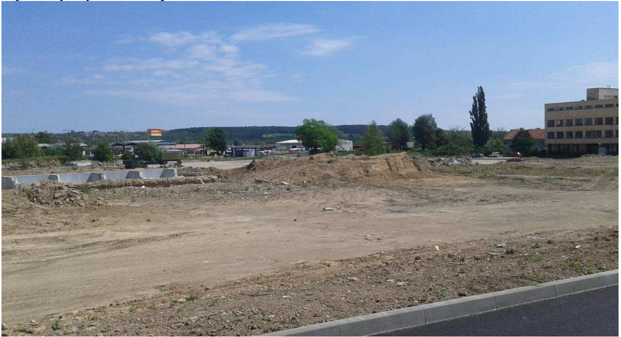
Obr. č. 6: Zemní práce a zakládání stavby, budou v důsledku složitého terénu a zbytků základů v bývalém průmyslovém areálu, vyžadovat poměrně náročné práce - i při nich musí být důsledně dbáno na ochranu ŽP (prašnost, případný výskyt NO)
