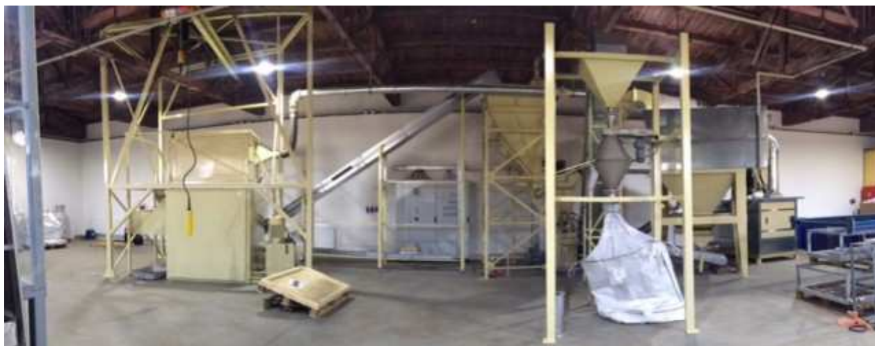
Obr. 2 Technologická linka pro mletí katalyzátorů – na levé straně je viditelný elektrický kladkostroj s předdrtičem, na který navazuje magnetický separátor. Odtud je materiál dopravován zapouzdřeným dopravníkem do násypky, ze které se materiál dávkuje do mlecího zařízení (uprostřed vzadu). Vpravo je viditelný kapsový filtr a úplně vpravo zařízení s ventilátorem a filtrem. Vpředu je pak násypka se zařízením na odběr vzorku, pod kterým se nachází big bag, do něhož bude pomletý materiál ukládán. Na obrázku je dobře patrné provedení odsávání předdrtiče (vodorovné potrubí nahoře uprostřed obrázku) a zapouzdřený dopravník.
