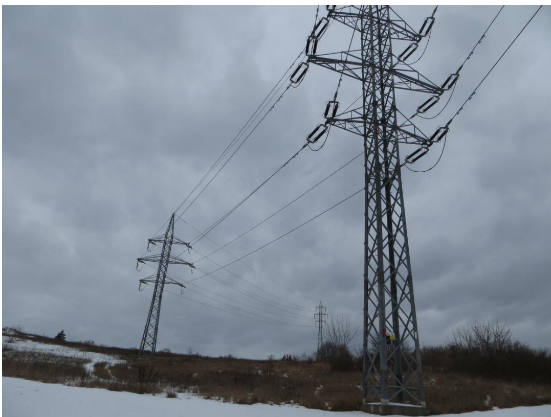
Obr. 10 Trasa nadzemního el. vedení VVN 110 kV, které bude přeloženo do užšího souběhu se silnicí I/43.
