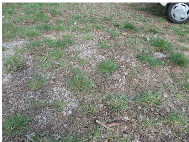
Obr. 3: Nedokonale upravená plocha parkoviště
