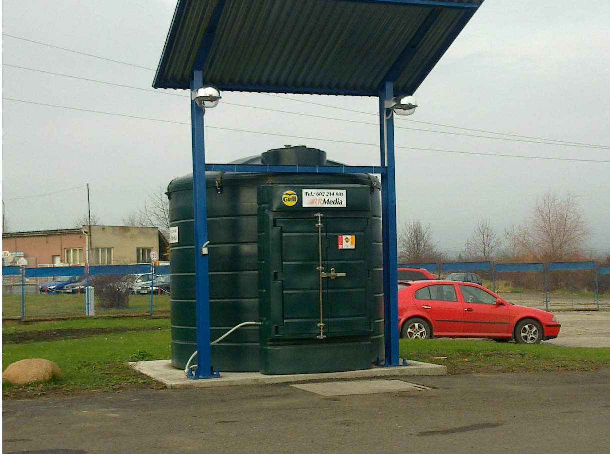
Obr. č.4: Ilustrační fotografie – instalace v Teplicích
