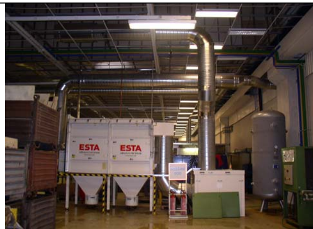
obrázek 7: Filtrační zařízení čištění kouřových plynů
