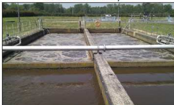
Denitrifikační a nitrifikační nádrže
