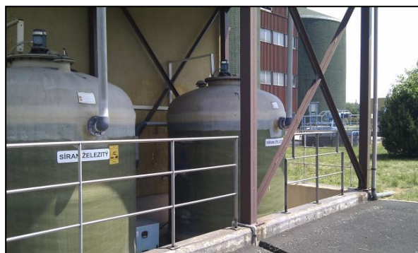
Nádrže na síran železitý
