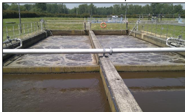
Denitrifikační a nitrifikační nádrže
