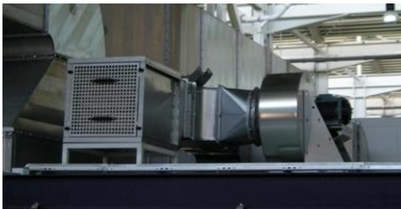
Obrázek 10 : Odsávací ventilátor pro režim sušení
