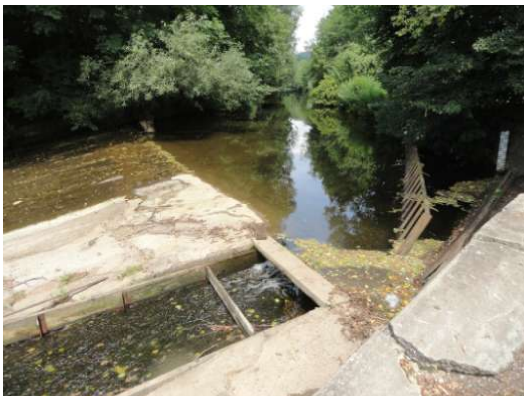
Obr. 2 Hrana dosavadního nyní zcela nefunkčního jezu a vpravo odběr pro MVE
