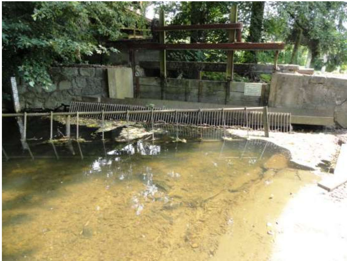
Obr. 8: Nadjezí, odběrové místo pro MVE je před rekonstrukcí viditelně poškozené
