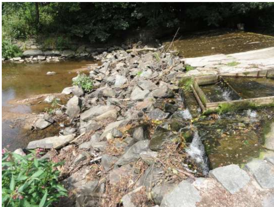
Obr. 4: Detail stavu jezu a poškození pravého břehu
