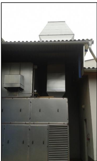
větrací jednotka lakovny
