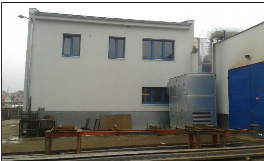
větrací jednotka svařovny
