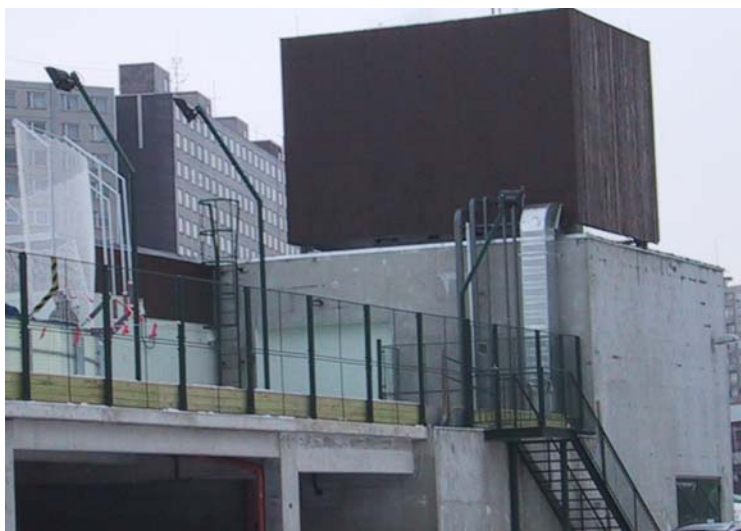
obr.5 Pohled na současné umístění chlazení
