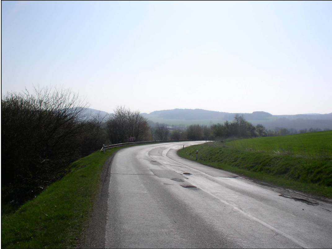
fotodokumentace č. 1 Úsek silnice II/230 nad obcí Kokořov charakterizující její současný technický stav
