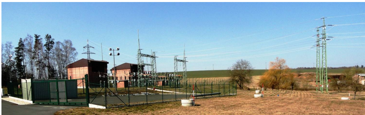
FOTO č. 1: Nový port rozvodny Domažlice (RODO) , původní starý port je vlevo (na titulní stránce) dokumentu
