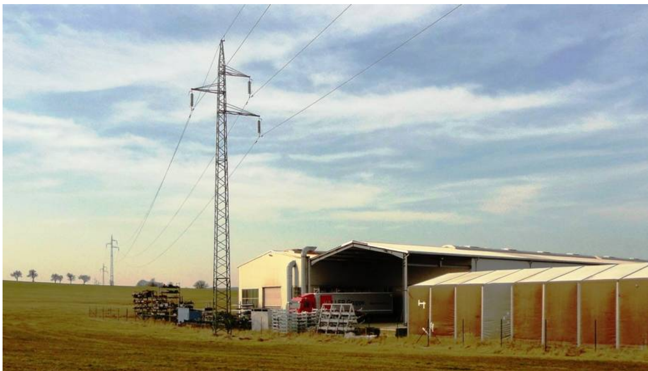
FOTO č. 6: Stožár č. 17 je nutné přeložit doleva, vzadu ST16 a 15.
