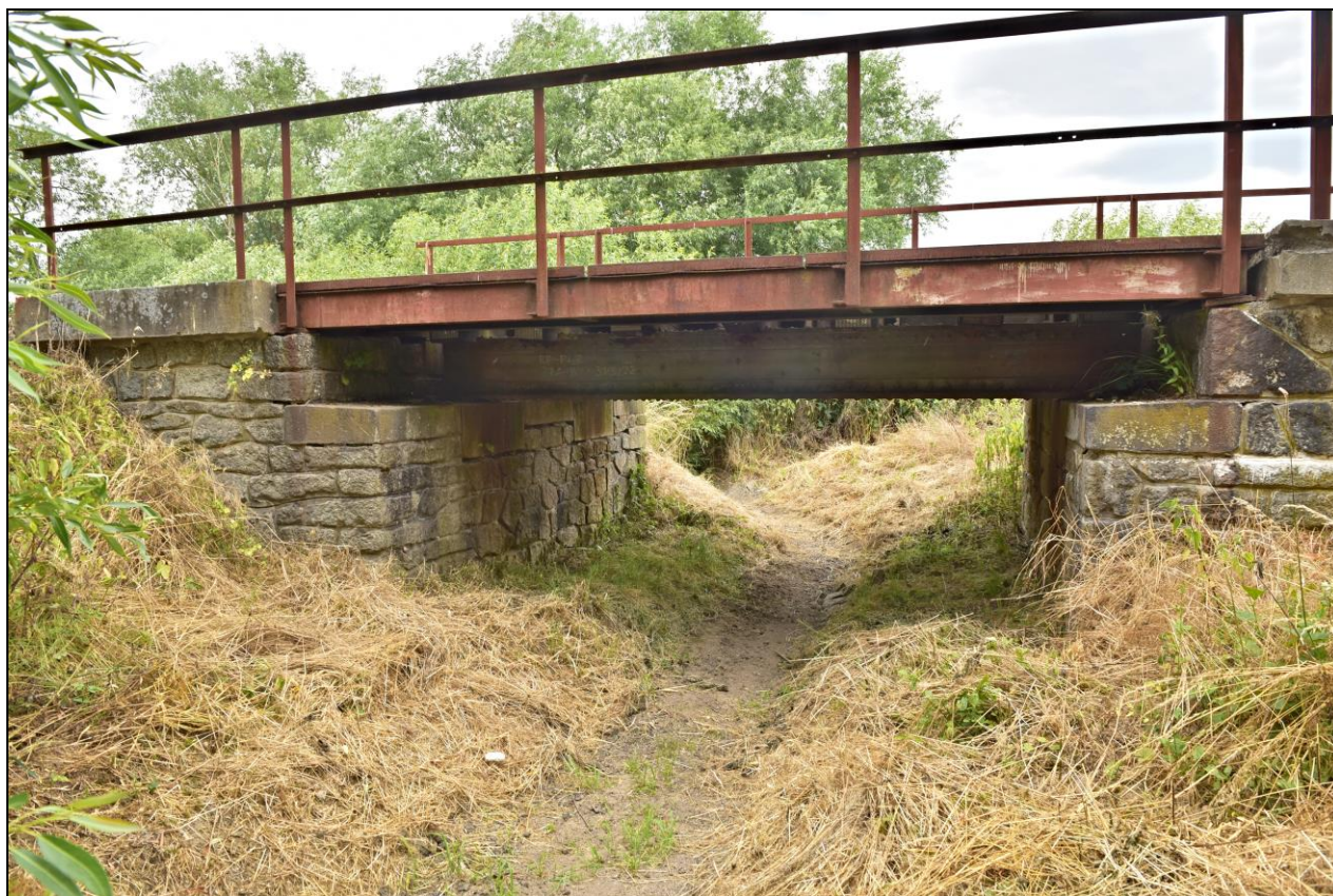
Koryto Vlkýšské potoka, křížení toku s železnicí, stav červen 2023, zcela suchý
