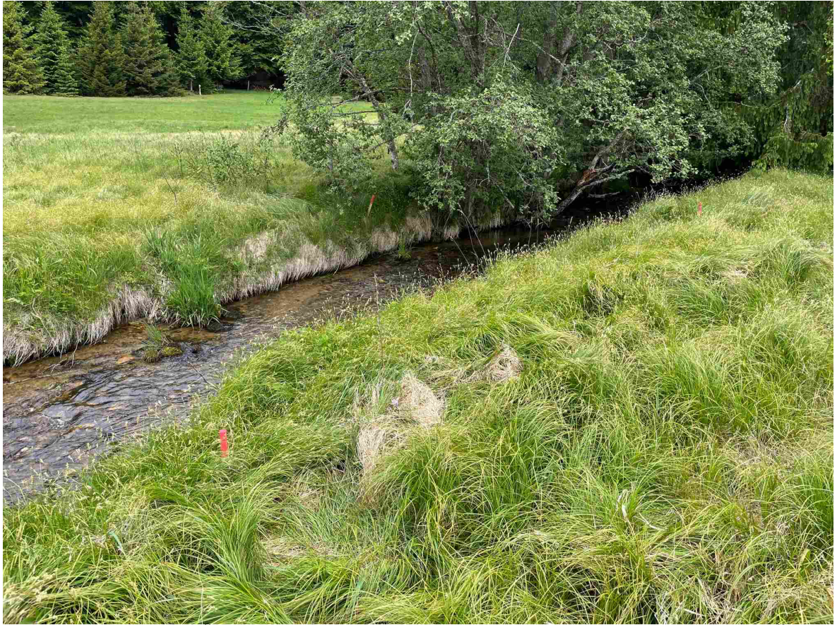
Tok Rezné v místě plánovaného zbudování jezového a odběrného objektu MVE Rezná.
