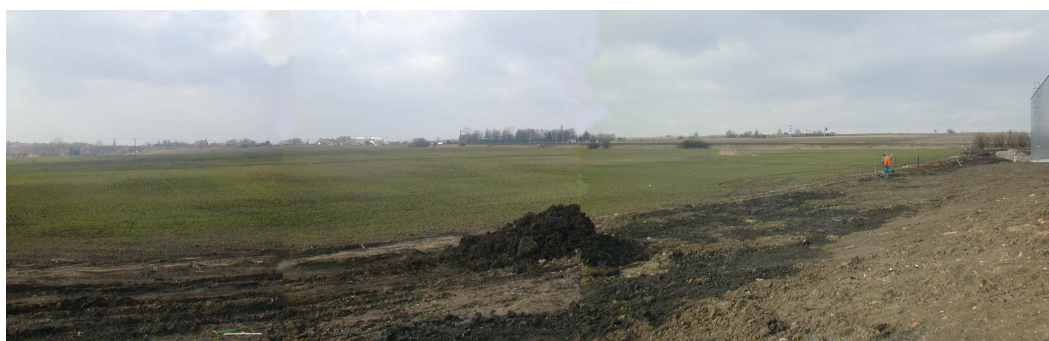
Pohled na staveniště II. etapy TP Hostivice od stávajícího skladu ve směru na trať a Hostivice
