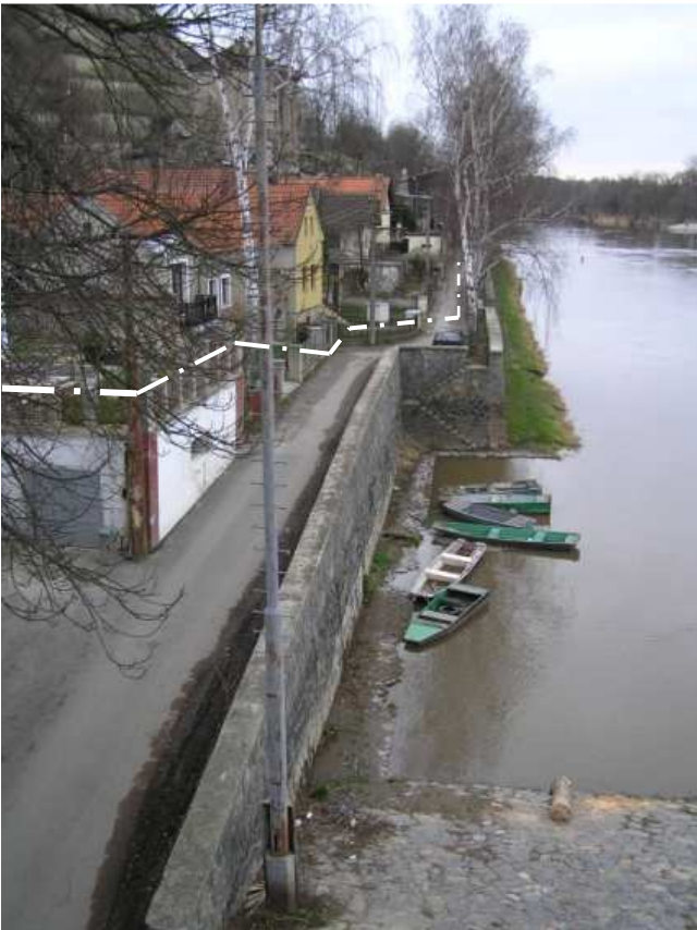
pohled na lokalitu Rybáře ze silničního mostu – vyznačena zhruba úroveň koruny protipovodňové bariéry
