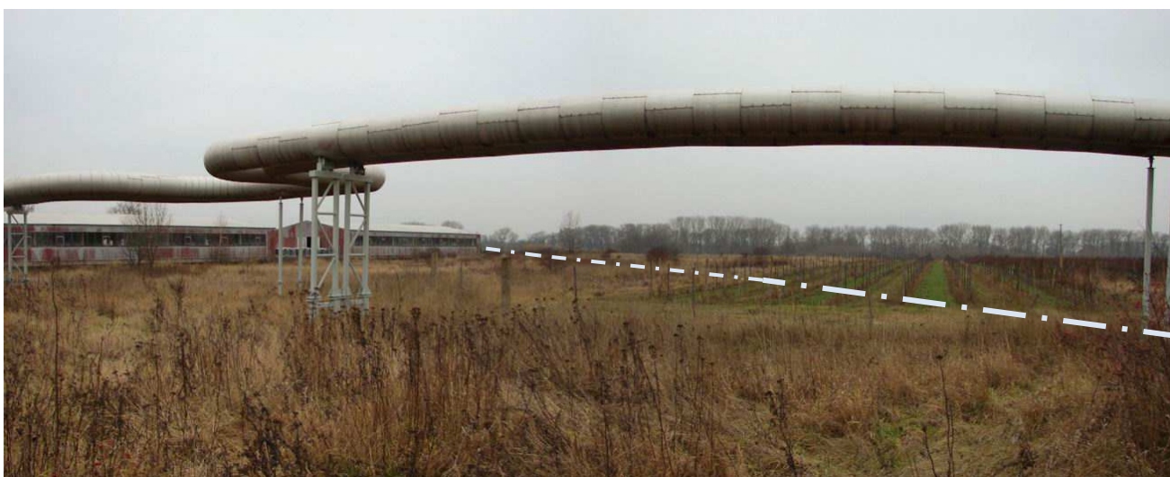
pohled na trasu linie PPO, vlevo areál zahradnictví, v pozadí porosty podél Mlazických tůní
