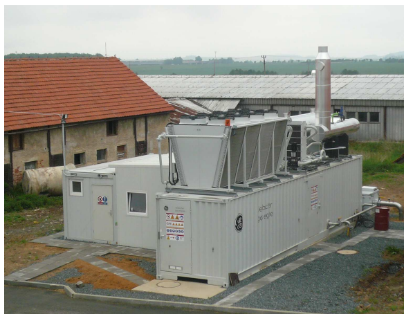
Kogenerační jednotka v kontejnerovém provedení
