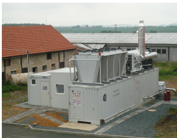
Kogenerační jednotka v kontejnerovém provedení
