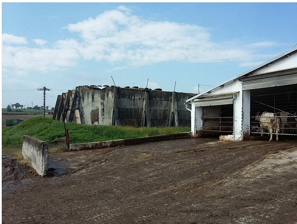
Žlab a stáj určená k demolici
