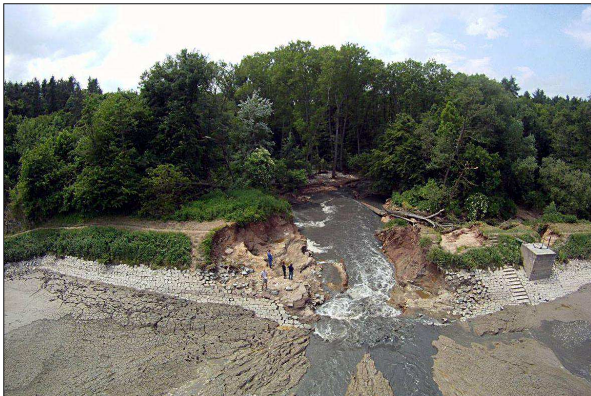
Obr. 16: Snímek protržené hráze rybníka Strašík přibližně týden po ničivé povodni – 9. 6. 2013 (zdroj: © www.ct24.cz ).
