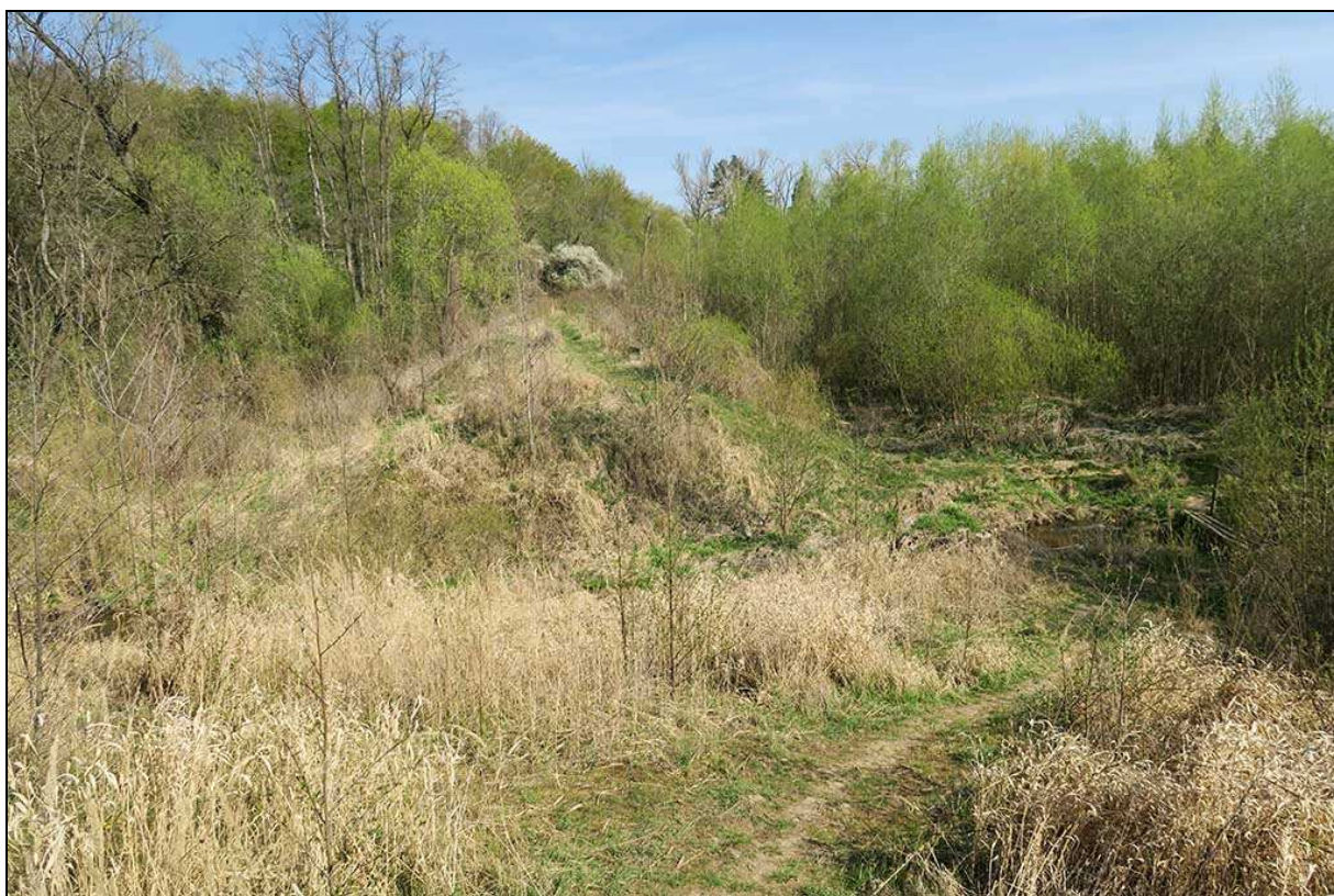
Obr. 28: Hráz rybníka Strašík v místě protržení (17.4.2020; foto: V. Lemberk).
